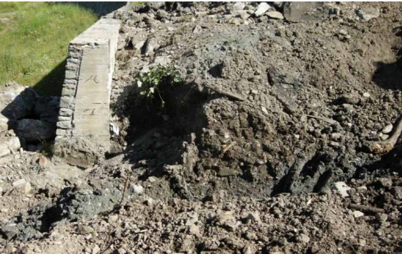
ESEMPIO DI CATTIVA OPERAZIONE DI RIEMPIMENTO DI TERRA DIETRO AL MURO DI SOSTEGNO
